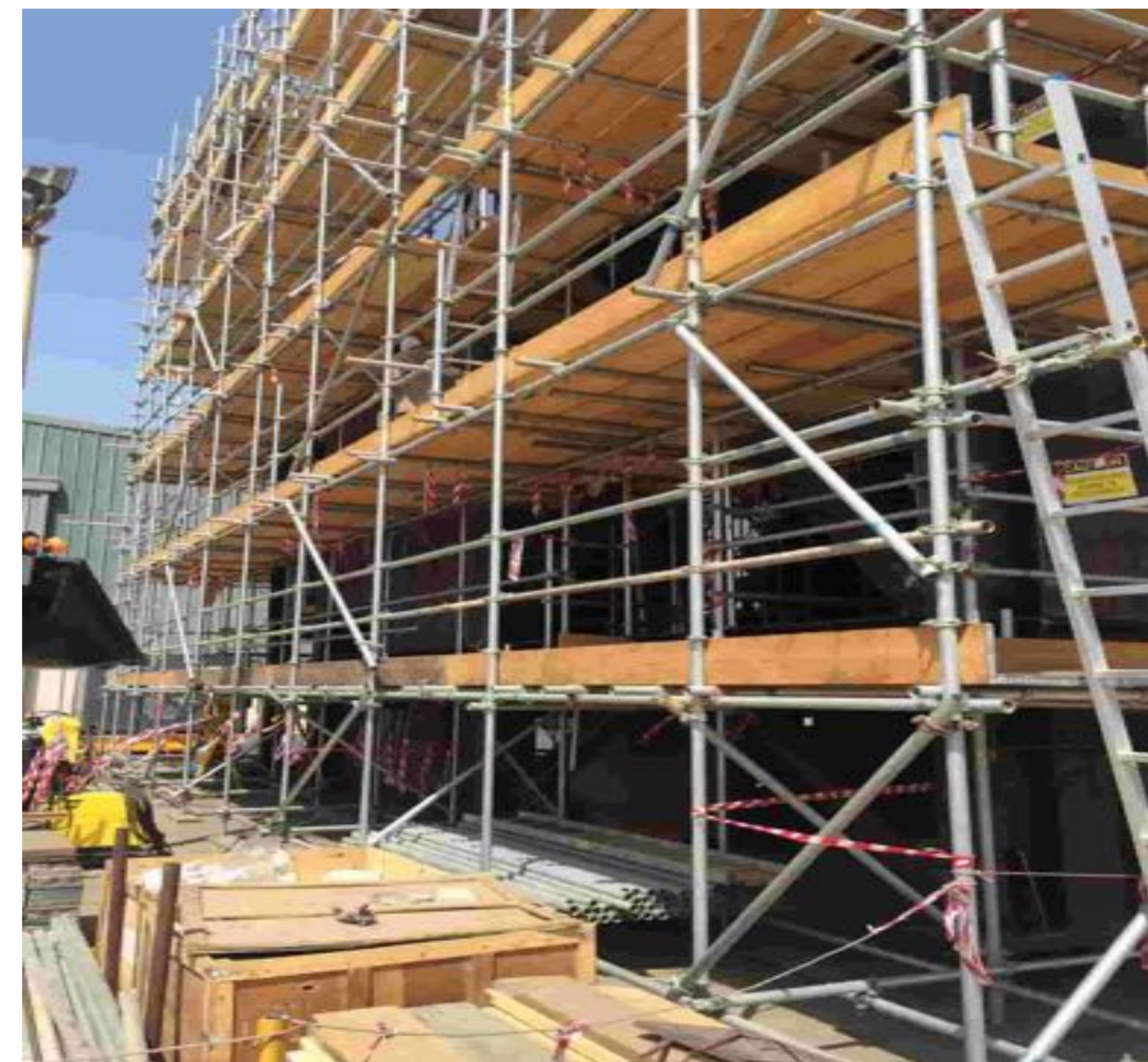
Система труб и фитингов Duscaff, установленная на проекте Aramco
